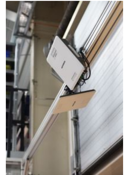
KATHREIN RRU 4500 Reader wurden direkt über dem Verladetor installiert.
